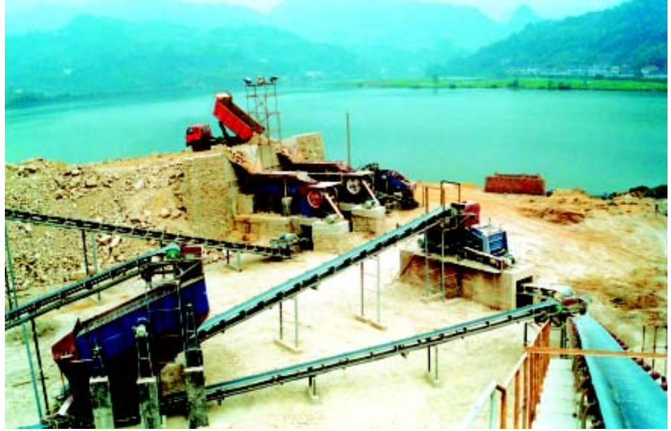
四川马边河舟坝水电站 400t/h骨料加工系统
